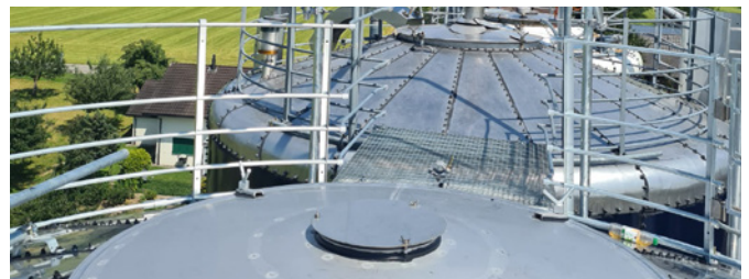
Outre les garde-corps et les protections contre les chutes près de l'ouverture de remplissage, des passerelles suffisamment larges et antidérapantes sur les silos-tours augmentent la sécurité lors du travail (photo : Système Silo GB)
