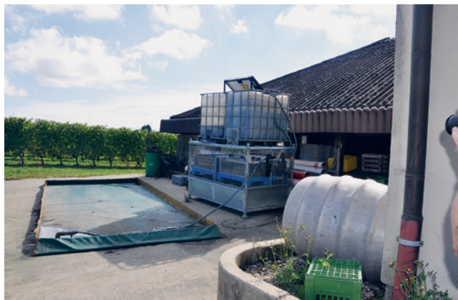
Piazza di lavaggio mobile: l'acqua di lavaggio, durante la pulizia, viene continuamente pompata nel serbatoio di raccolta. A causa della mancanza di un tetto, il telone deve essere smontato e riposto in magazzino dopo l'uso per evitare lo straripamento in caso di precipitazioni, M. Hochstrasser.
