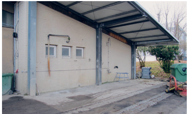
Aire de remplissage du pulvérisateur: Dalle de béton couverte avec potences et grilles de drainage, B. Arnold.
