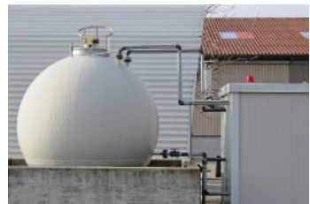
Figura 6: cisterna fuori terra con bacino di ritenzione (AGRIDEA).
