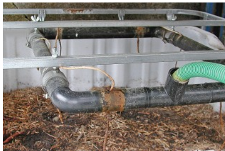
Figura 11: aspersione sul Biofiltro (Agrilogie).
