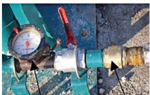
Foto 3: Mechanischer Durchflusszähler mit Anti-Rücklaufventil (G. Fiaux, 2007)
