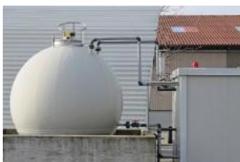
Foto 6: Oberirdischer Tank mit Rückhaltebecken (AGRIDEA)
