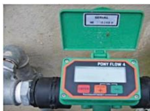
Foto 4: Elektronischer Durchflusszähler (G. Fiaux, 2007)
