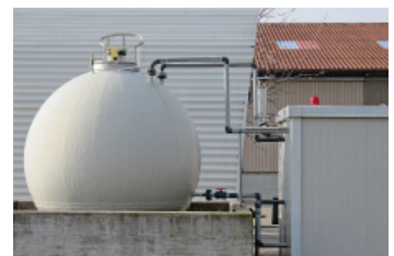
Photo 6: cuve tampon hors sol avec bac de rétention (AGRIDEA).
